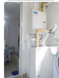
灯油ボイラー
